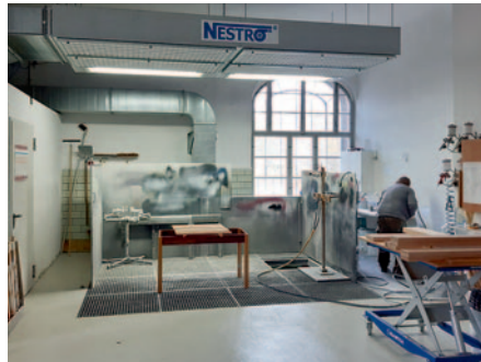
Moderner Lackierarbeitsplatz mit Bodenabsaugung des Farbnebels
